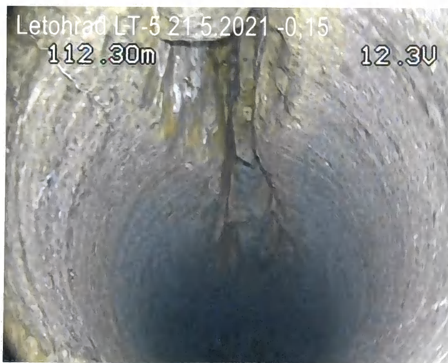
Obr. č. 24: Puklina a přítok v hloubce 112,3 m od OB.
