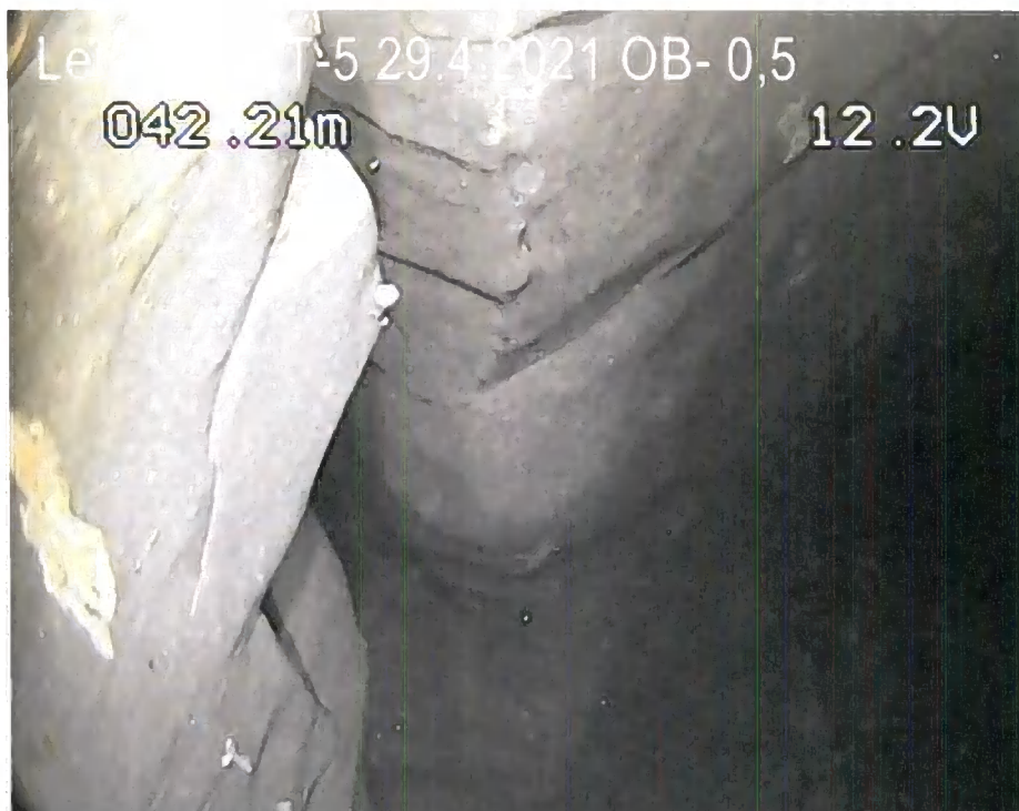
Obr. č. 11: Drobná porucha v hloubce 42 – 43 m od OB.
