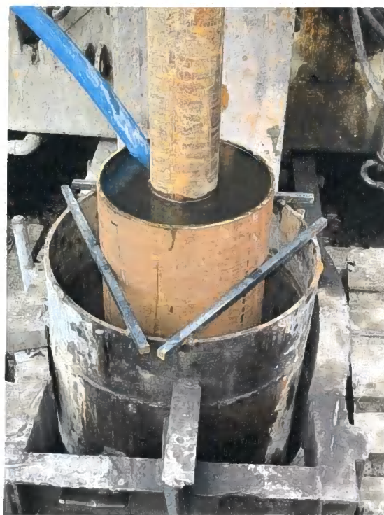
Obr. č. 17: zapuštění cementačních tyčí do cementační paty a příprava na začerpaní bentonitové směsi do mezikruží ocelové pažnice \varnothing 324/8 mm a cementačního potrubí.
