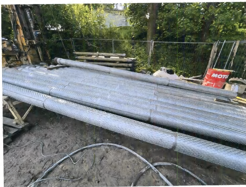
Obr. č. 26: Vystrojovací práce na lokalitě – nerezová výstroj Ø 219,1/3 mm s můstkovou perforací, šířka slotu 3 mm.
