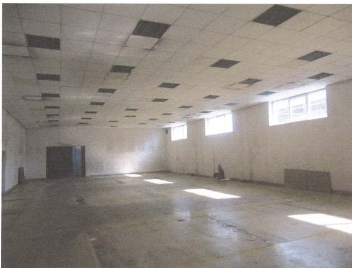
Pohled na stropní sálavé panely v Zóně 2 – Sklad
