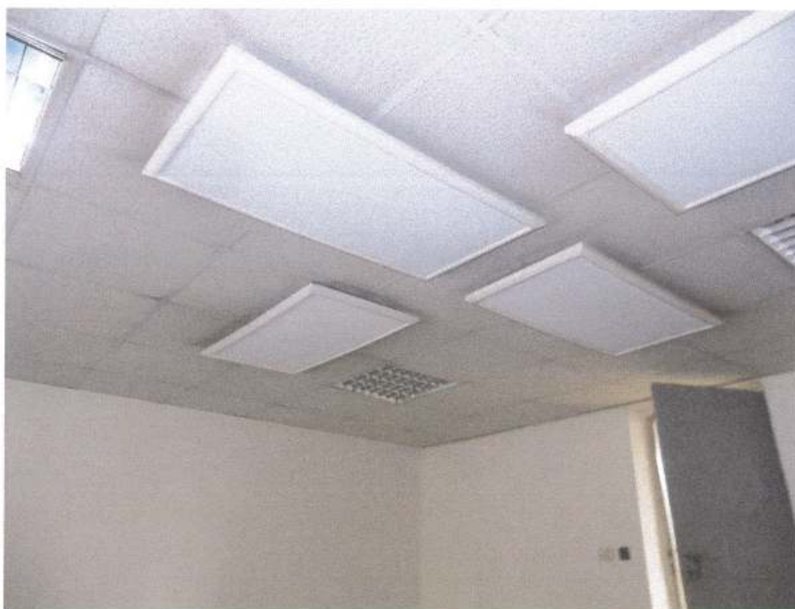
Pohled na sálavé stropní panely v Zóně 3 – Prostory k pronájmu
