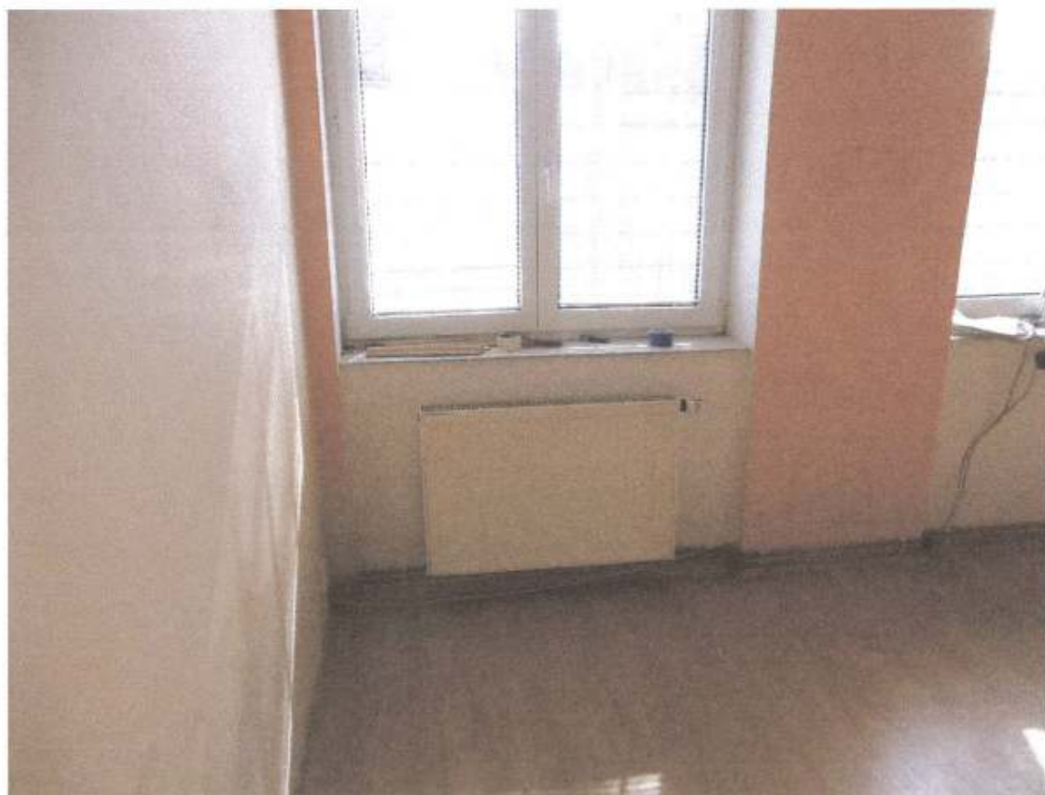
Deskové otopné těleso v Zóně 1 – Kanceláře
