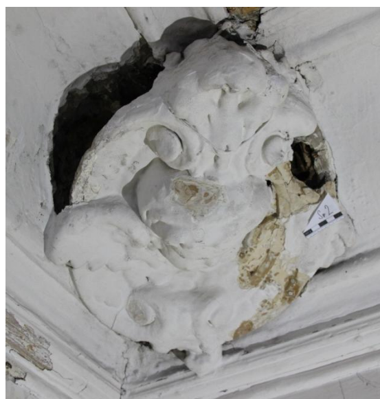
Obr. 7: Poškození kartuše vlevo od vstupních dveří
