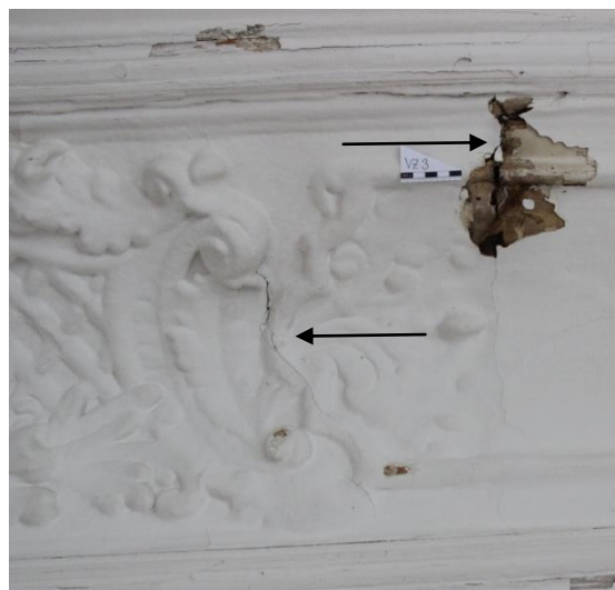
Obr. 3: Praskliny na fabionu vlevo u okna do náměstí
