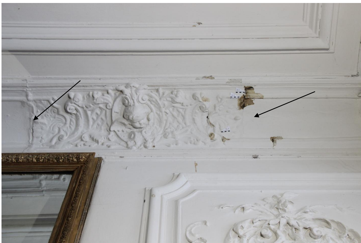
Obr. 26: Část fabionu vlevo u okna, šipky ukazují na spáry mezi hladnými a zdobnými poli, hladkých polí je cekem 20 kusů
