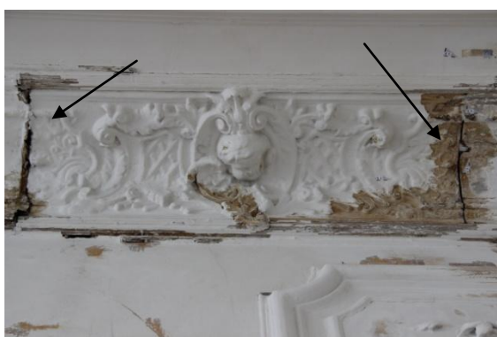
Obr. 4: Praskliny na fabionu vlevo od vstupních dveří
