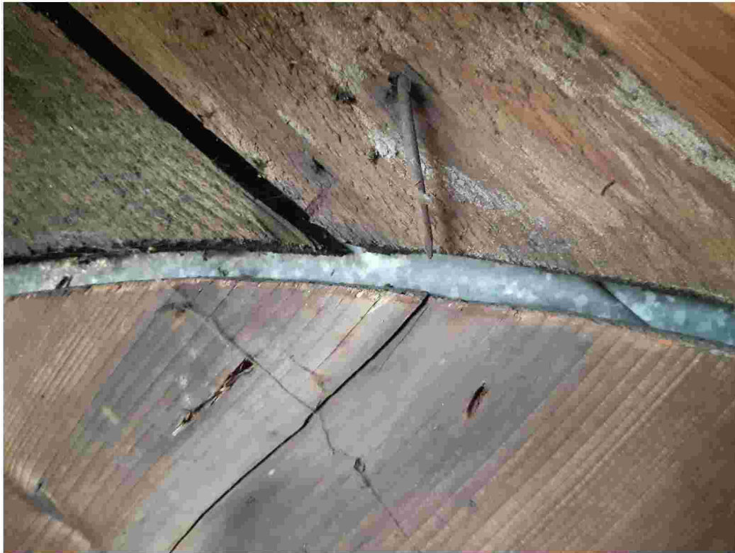
Boční ciferník z rubu - ocelový potah je z pozinkovaného plechu, tedy novodobý, za jeho přesahující okraje je přichycen k dřevěnému ostění věže
