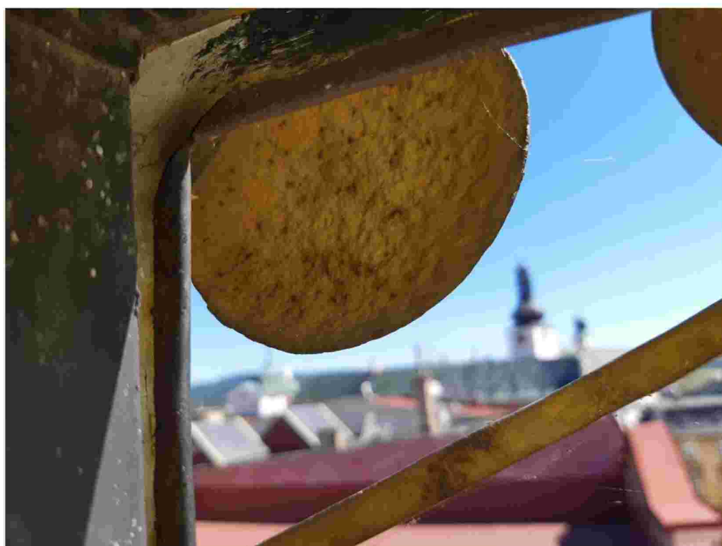
Korozní produkty na rafijích
