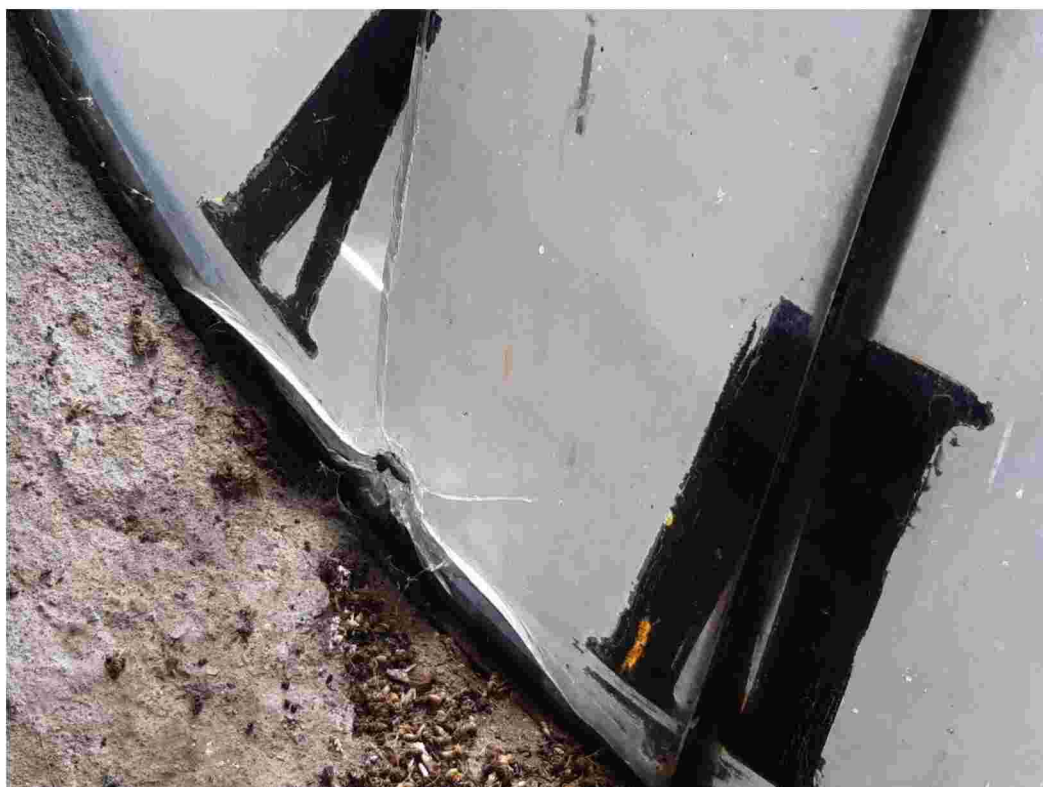
Průčelní ciferník, prasklina pravého dolního segmentu, foto zevnitř
